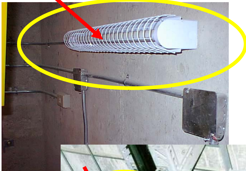
แสงสว่างในบ่อลิฟต์ (Pit lighting)
